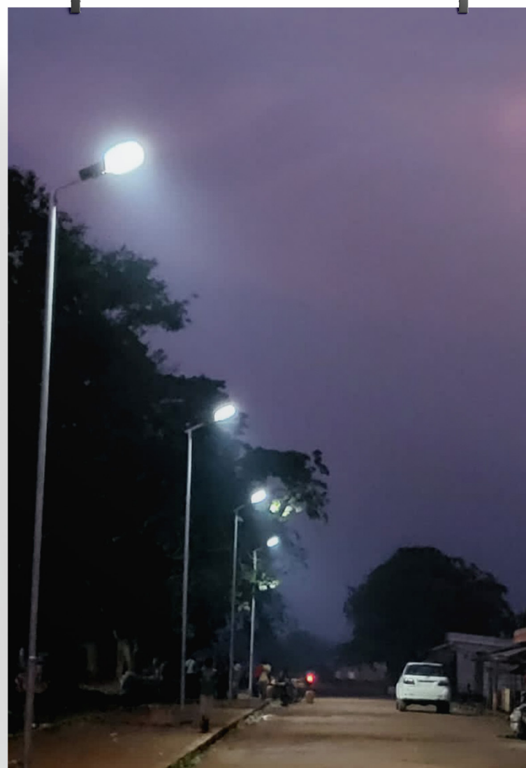
Projet d'éclairage public des artères des chefs-lieux de 5 provinces de l'espace Grand Equateur
